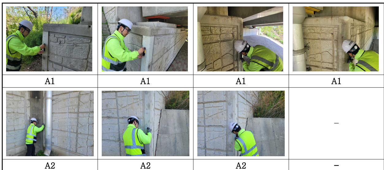
【사진 1.3.10】 교대 기울음 측정 현황
