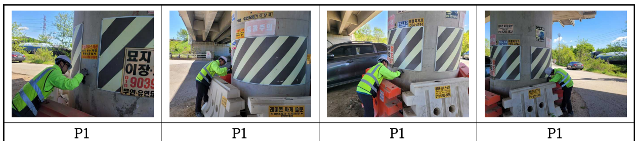
【사진 1.3.13】 교대 기울음 측정 현황
